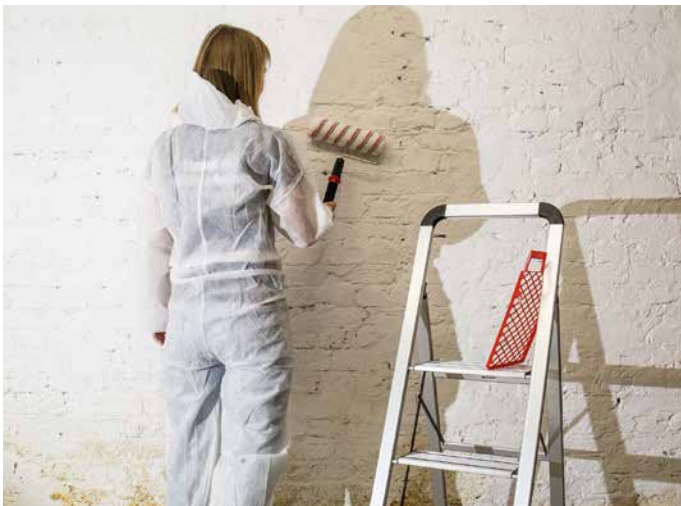
So nicht: Schatten fällt auf den Arbeitsbereich
